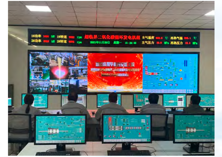
超临界二氧化碳透平发电机组投运监测现场
